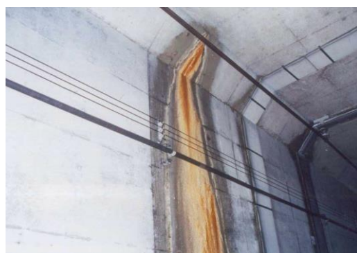
図-1 開削トンネルにおける漏水状況の例 9)
