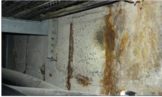
写真 5.3.3.1 塩害による腐食状況（開削 T）
